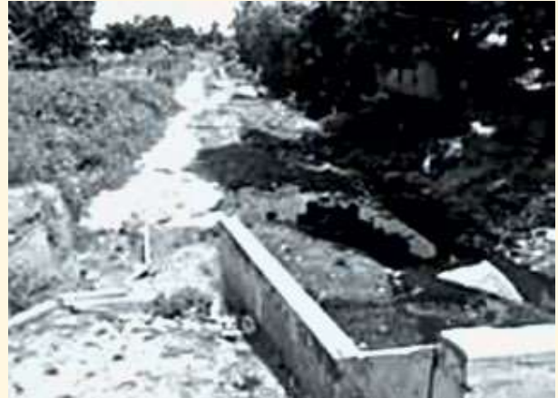
Dreno principal na cidade de Tamale, Gana. Foto: Kranjac-Berisavljevic
