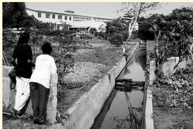
Típico dreno de águas servidas em área urbana de Accra, Gana Foto: Margaret Armar-Klemesu
