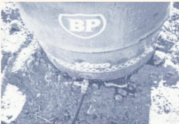
Después de cerca de dos años de uso los tambores empezaron a filtrar ya que el óxido había destruido el metal del tambor en el sitio donde se lo había perforado para insertar el tubo de salida.
